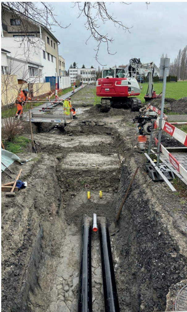
Ringschluss Anergienetz Altenrhein: im Bereich Föhnpipe
