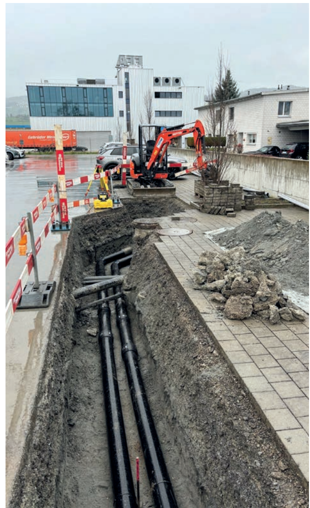
Ringschluss Anergienetz Altenrhein: im Bereich Medical
